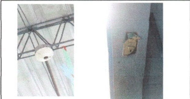
REPARACION SISTEMA ELCTRICO: Compra y colocacion de suministro de energia electrica (cable, plafonera, lamparas).
