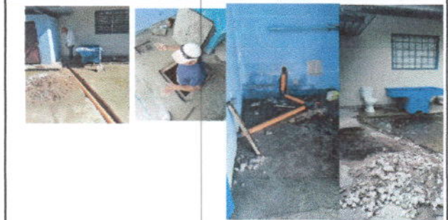
REPARACION DE RED DE DRENAJE Y RED DE AGUA POTABLE Limpieza de fosa séptica de 4 M3, Compra de pilas, Reparacion de drenajes para pilas
